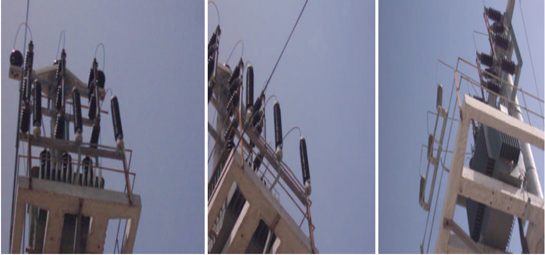
Resim 2.11: Trafo direğinde parafudur bağlantıları
