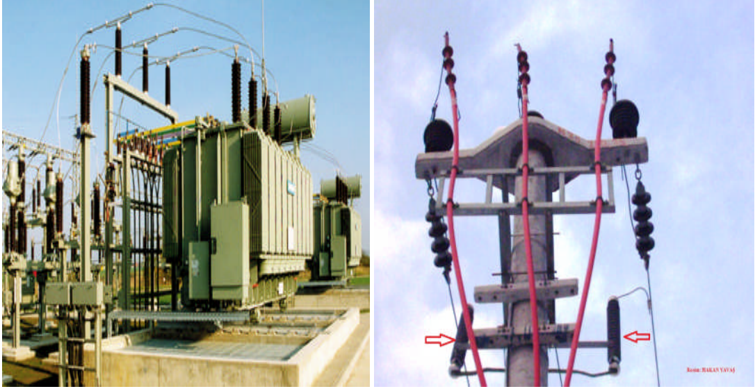
Resim 2.1: Trafo merkezi ve hava hattı ile yer altı kablosu birleşim noktasında parafudurlar
