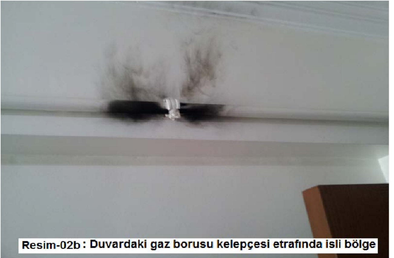
Resim-02a: Duvardaki gaz borusu kelepçesi etrafında isli bölge
